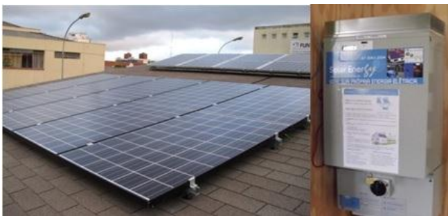
Figura 2 – Painel FV e inversor do EV da UTFPR.
