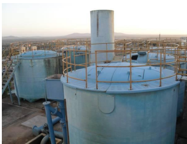
Figura 1 - Foto dos filtros ascendentes da ETA de Palmeira dos Índios
