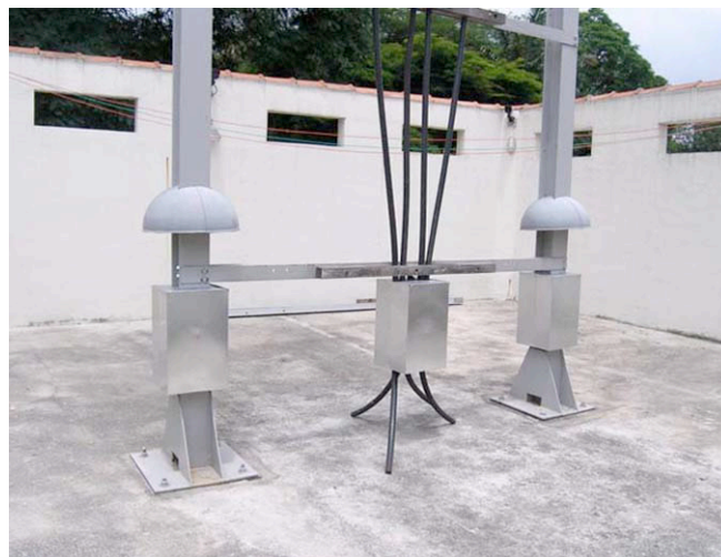
Figura 3 - Barreiras físicas de fibra de vidro em forma de meia-lua, instaladas nas vigas em I, e caixas de chapa galvanizada, fechadas no topo, envolvendo os cabos emborrachados e as bases das vigas em I do pórtico
